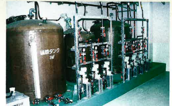
薬品注入設備
