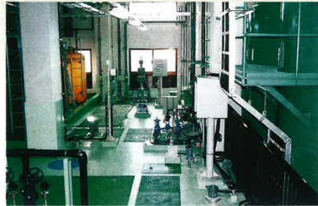
凝集沈殿処理設備、他
