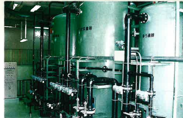
砂ろ過・活性炭吸着処理設備
